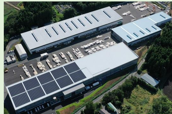
写真：水戸工場EF棟屋根上の太陽光発電パネル
